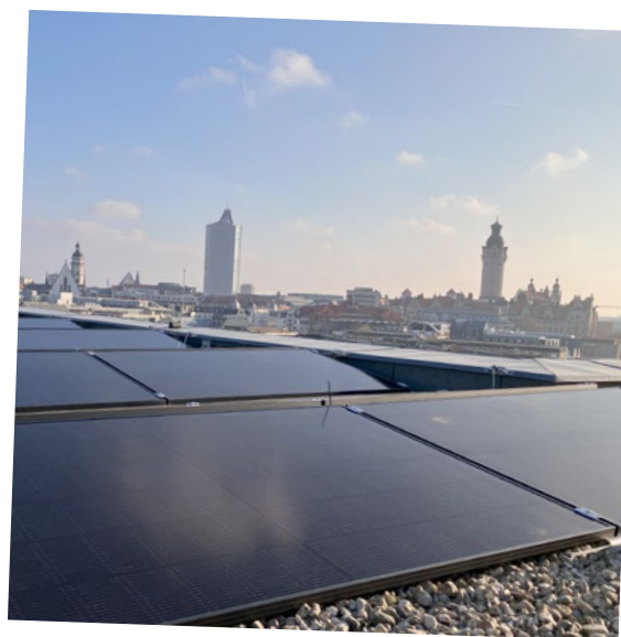
Unsere Photovoltaikanlage auf der Geschäftsstelle, Käthe-Kollwitz-Straße 37
